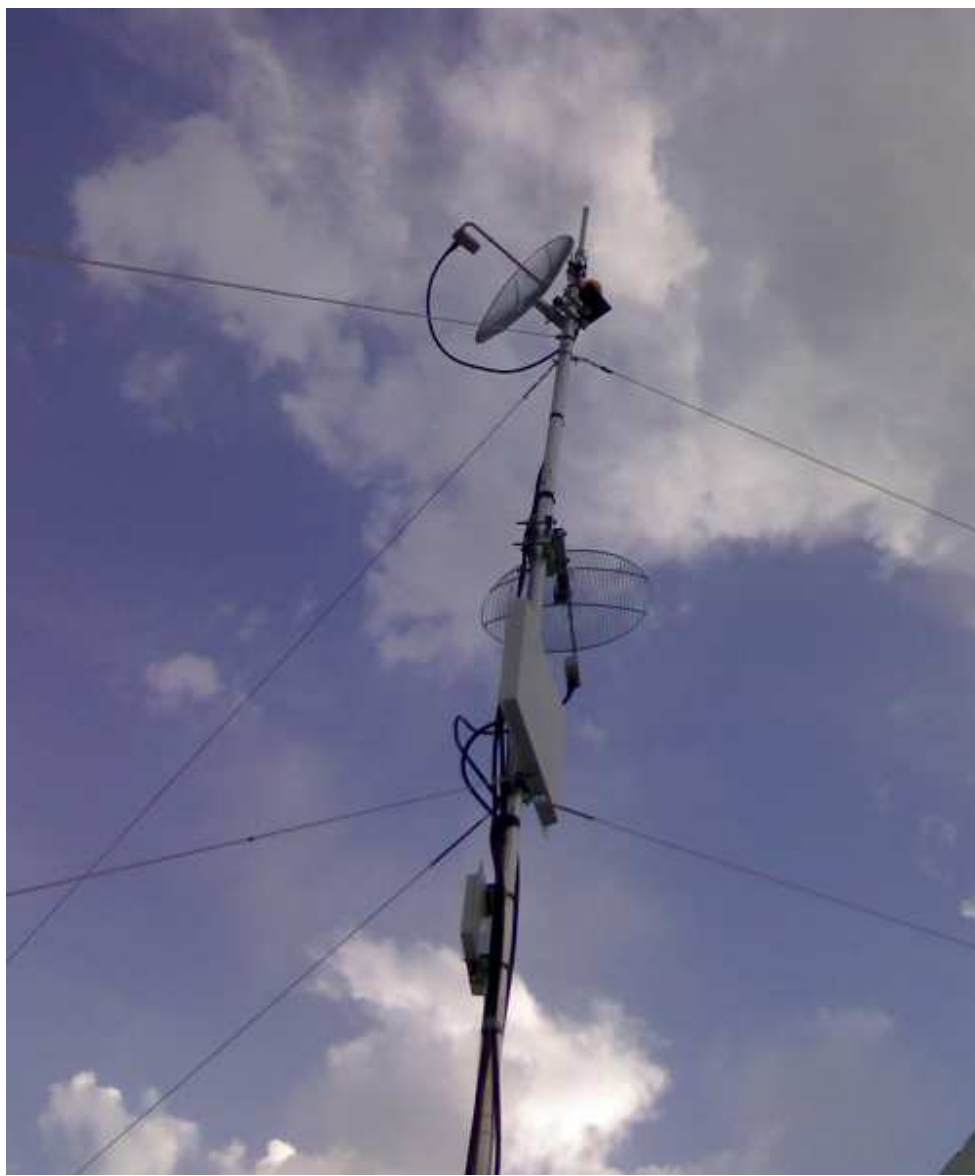
Φωτογραφία κεραιοσυστήματος κόμβου δικτύου
