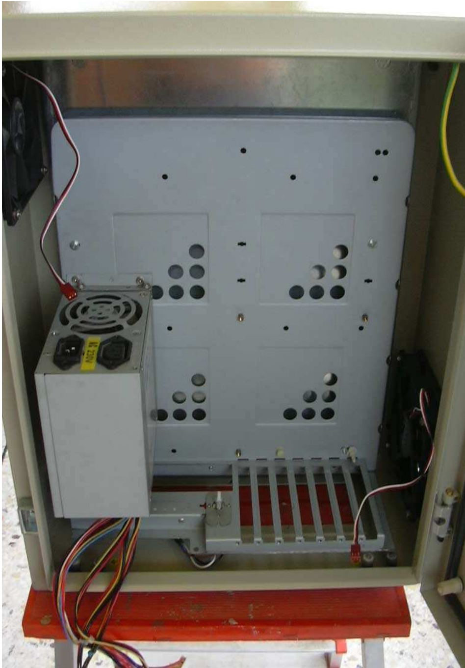
Η πλάτη ενός BTX κουτιού τοποθετημένη στην πλάτη του ηλεκτρολογικού πινάκα.
