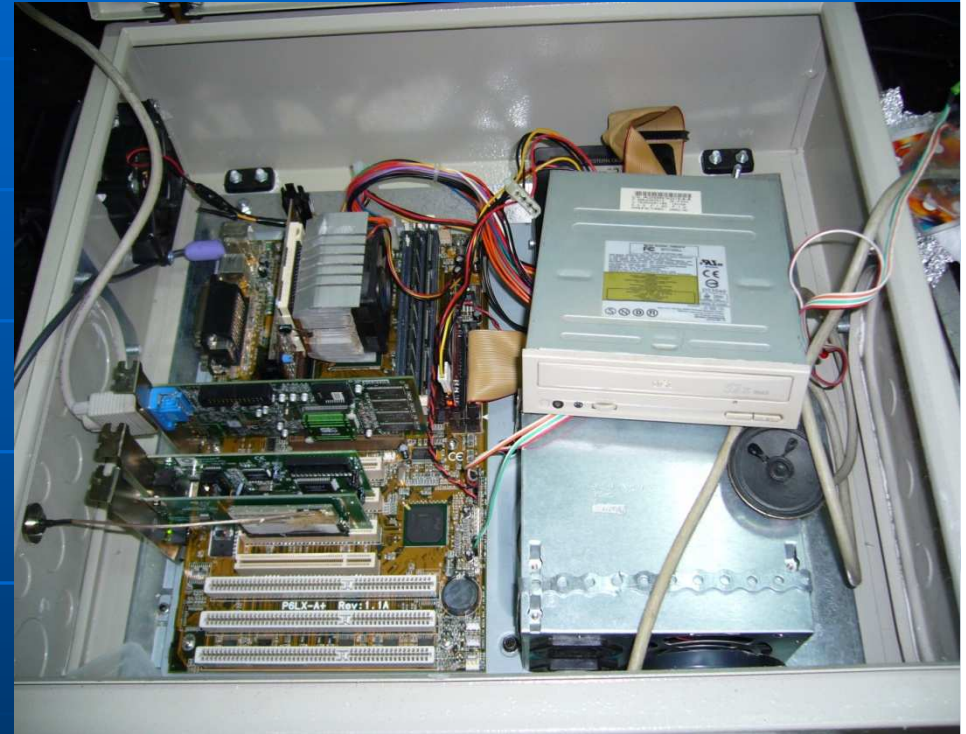
Πρόχειρη τοποθέτηση CD-ROM
