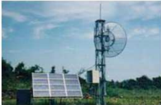
Εφαρμογή φωτοβολταϊκών στις τηλεπικοινωνίες
