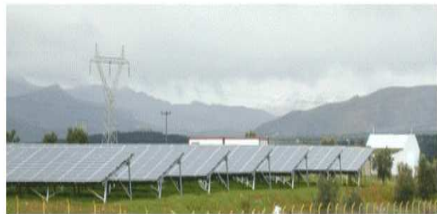
Ηλιακός σταθμός ηλεκτροπαραγωγής στην Κρήτη
