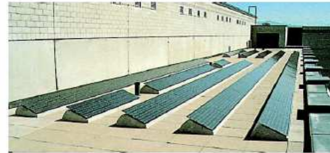
Εφαρμογή φωτοβολταϊκών σε ταράτσα κτιρίου
