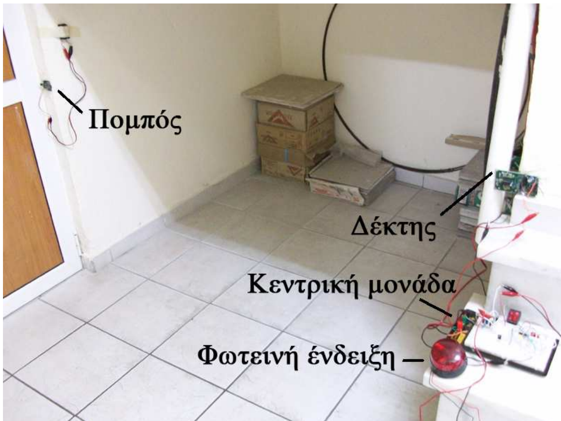
Σχήμα 4-36: Φύλαξη χώρου χρησιμοποιώντας τον αισθητήρα δέσμης υπέρυθρων. Η συγκεκριμένη διάταξη μπορεί να χρησιμοποιηθεί για οποιαδήποτε είσοδο ή διάδρομο
