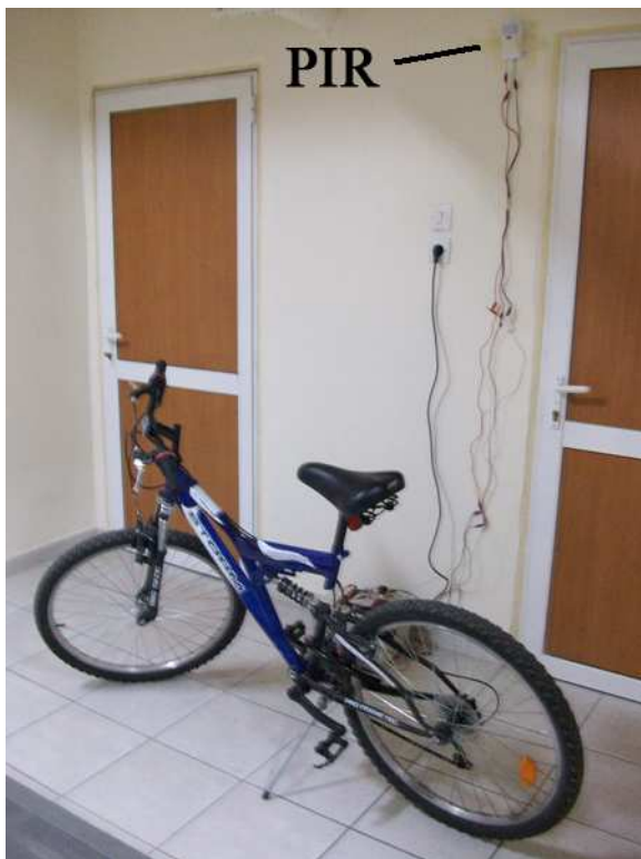
Σχήμα 4-38: Φύλαξη χώρου από τον PIR
