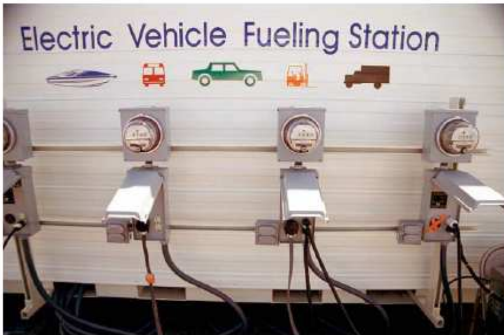
Σχήμα.2-1 Σταθμός ανεφοδιασμού Evs.
