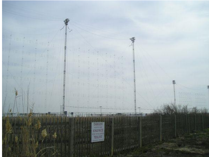
ΣΧΗΜΑ 11: ΚΕΡΑΙΕΣ PLUTO, ΤΥΠΟΥ ELF, ΕΓΚΑΤΕΣΤΗΜΕΝΕΣ ΣΤΙΣ ΑΓΓΛΙΚΕΣ ΒΑΣΕΙΣ ΣΤΟ ΑΚΡΩΤΗΡΙ ΛΕΜΕΣΟΥ, ΣΤΗΝ ΚΥΠΡΟ (ΑΠΟ ΜΕΤΕΩΡΟΛΟΓΙΚΗ ΥΠΗΡΕΣΙΑ ΚΥΠΡΟΥ)
