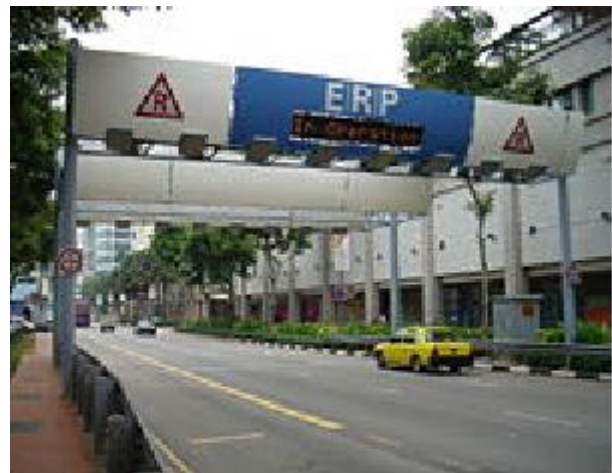
Σχήμα 13. Σημείο ηλεκτρονικής πληρωμής διοδίων
