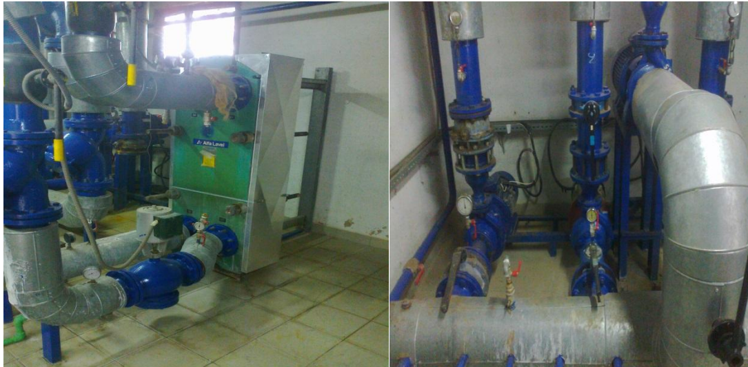
(Εικόνα 4.3 : Αριστερά εναλλάκτες νερού-νερού, Δεξιά αντλίες σε θερμικό υποσταθμό υποπεριοχής)
