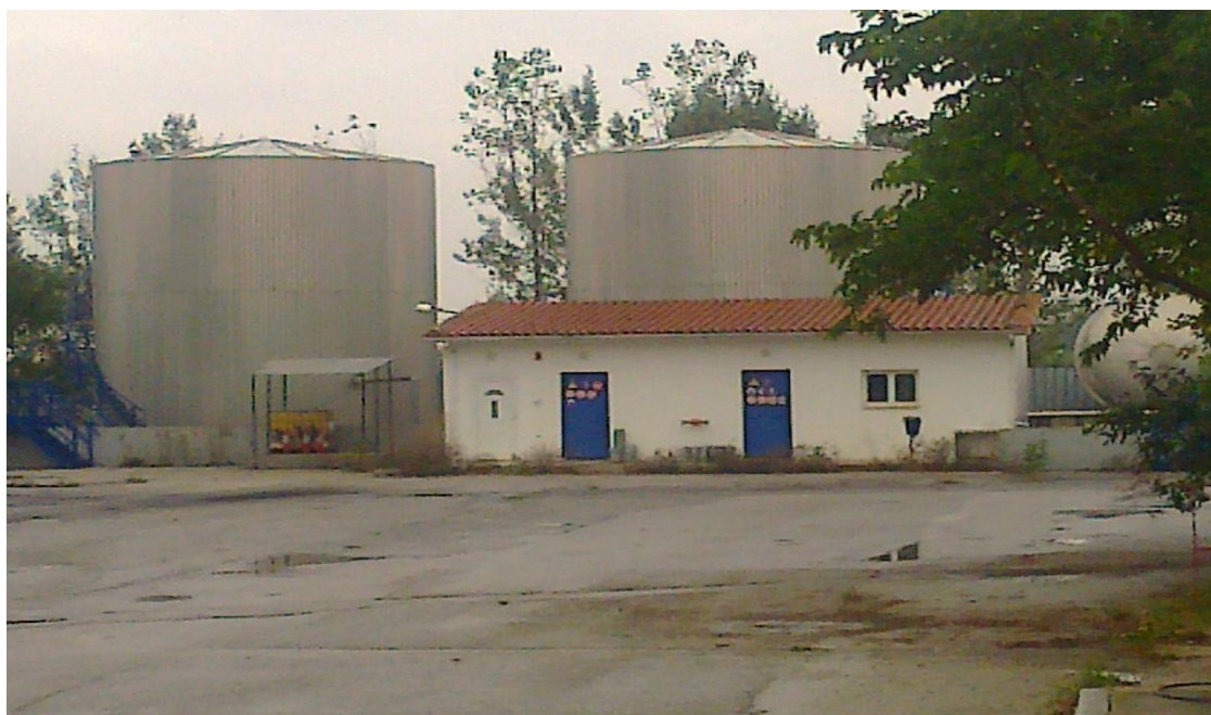
(Εικόνα 4.2 : Δεξαμενές συμπλήρωσης νερού)
