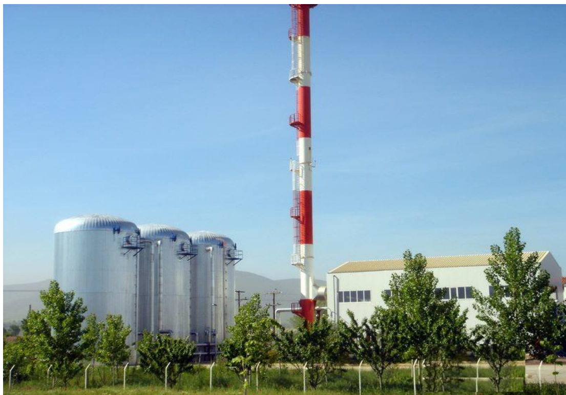
(Εικόνα 3.7 : Δεξαμενές αποθήκευσης θερμικής ενέργειας)
