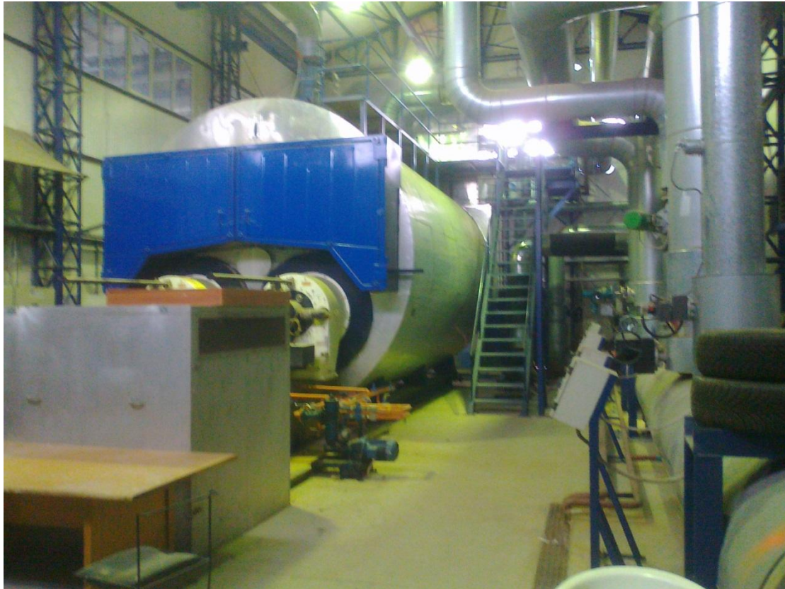
(Εικόνα 3.3 : Λέβητας Πετρελαίου)
