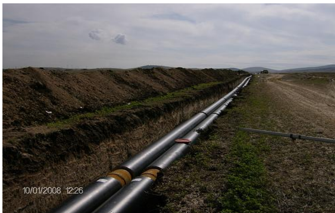
(Εικόνα 3.5 : Αγωγοί μεταφοράς από ΑΗΣ Καρδιάς)
