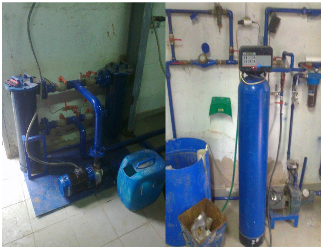
(Εικόνα 4.4 : Αριστερά φίλτρα τύπου <<σακό>>, Δεξιά σύστημα έγχυσης χημικών σε θερμικούς υποσταθμούς υποπεριοχών)
