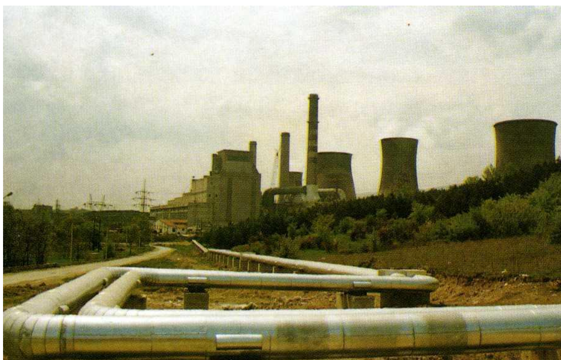
(Εικόνα 3.4 : Αγωγοί προσαγωγής και επιστροφής του ΑΗΣ Πτολεμαΐδας.)
