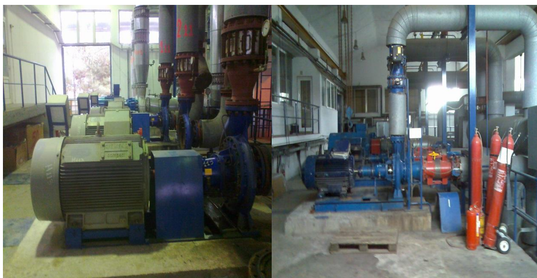
(Εικόνα 4.1 : Αντλίες υπέρθερμου νερού στο κεντρικό αντλιοστάσιο)
