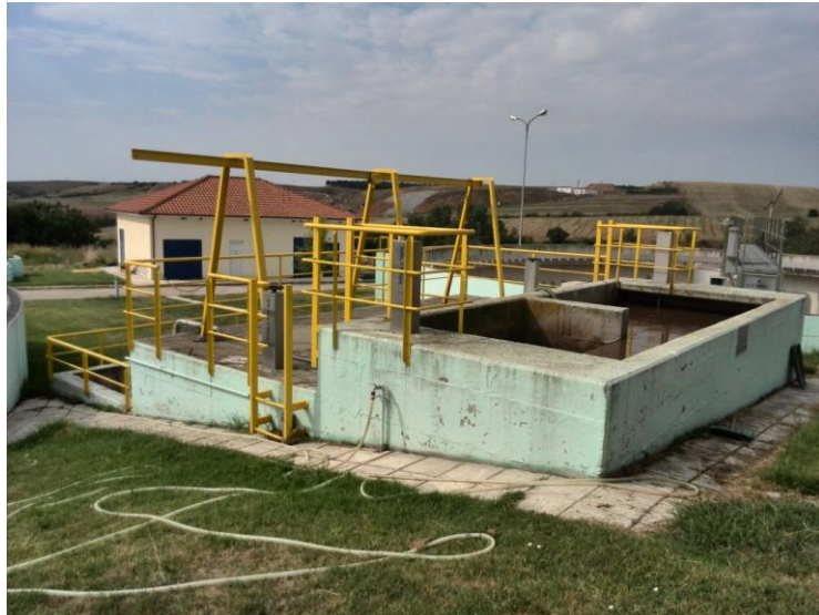
Σχ. 3.25.: Αντλιοστάσιο ανακυκλοφορίας και απομάκρυνσης λάσπης
