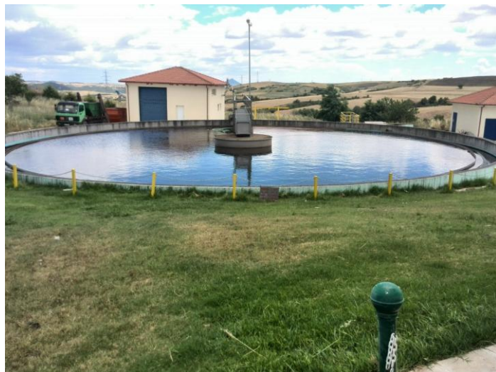
Σχ. 3.24.: Δεξαμενές δευτεροβάθμιας καθίζησης
