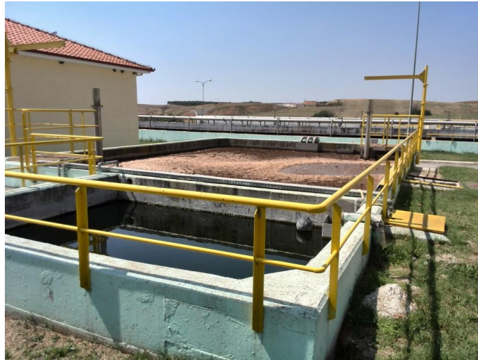
Σχ. 3.29.: Αεριζόμενη δεξαμενή ομογενοποίησης
