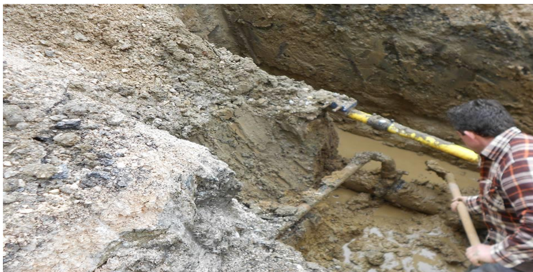
Εικόνα 6. Διαρροή σε σύνδεσμο υδροληψίας \Phi 150 \times 50
