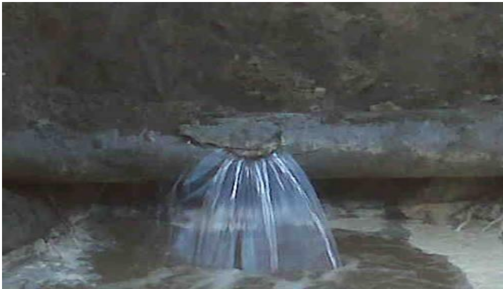
Εικόνα 4: Θραύση αγωγού Φ100 λόγω παλαιότητας
