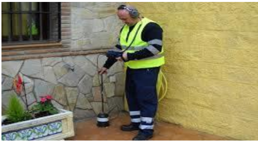
Εικόνα 16:Ανεύρεση διαρροής με γαιόφωνο
