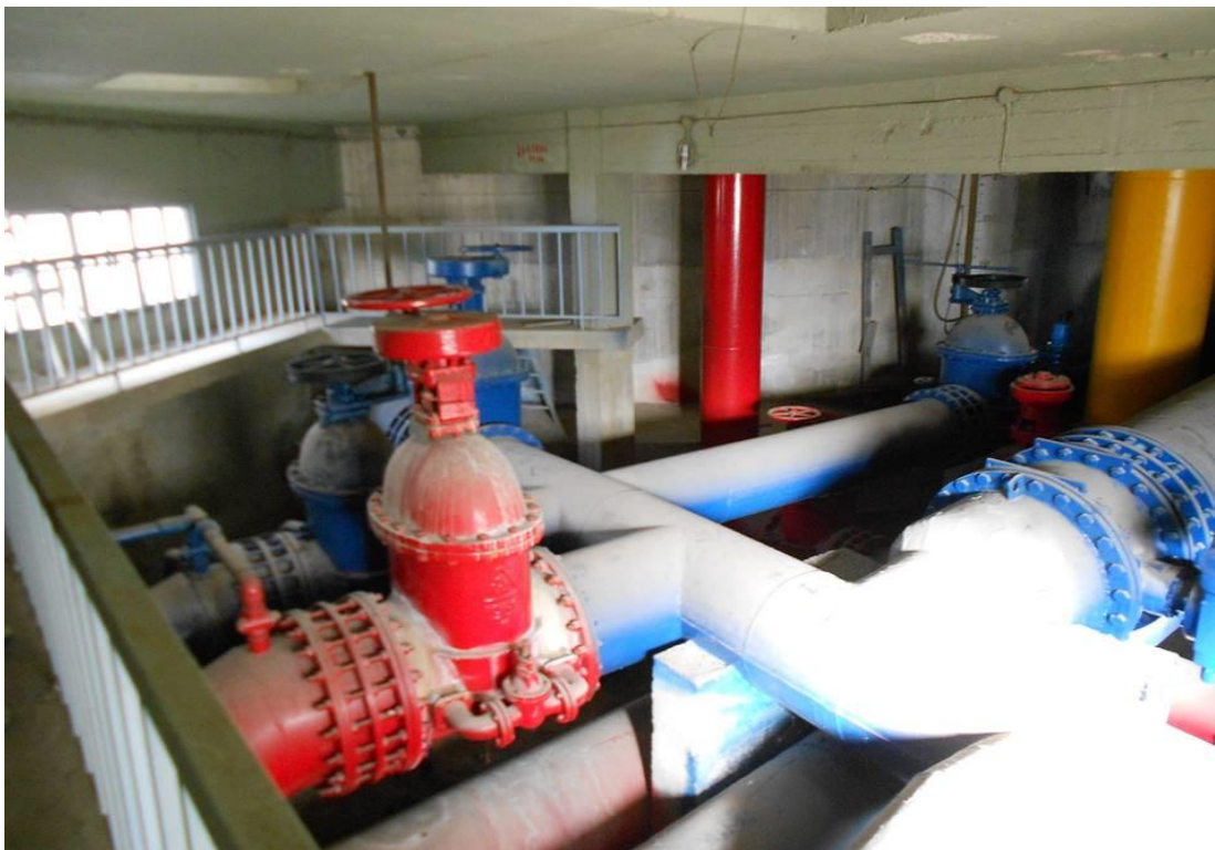
Εικόνα 1: Δίκτυο μεταφοράς, και διανομή νερού σε χώρο δεξαμενών και αντλιοστασίου
