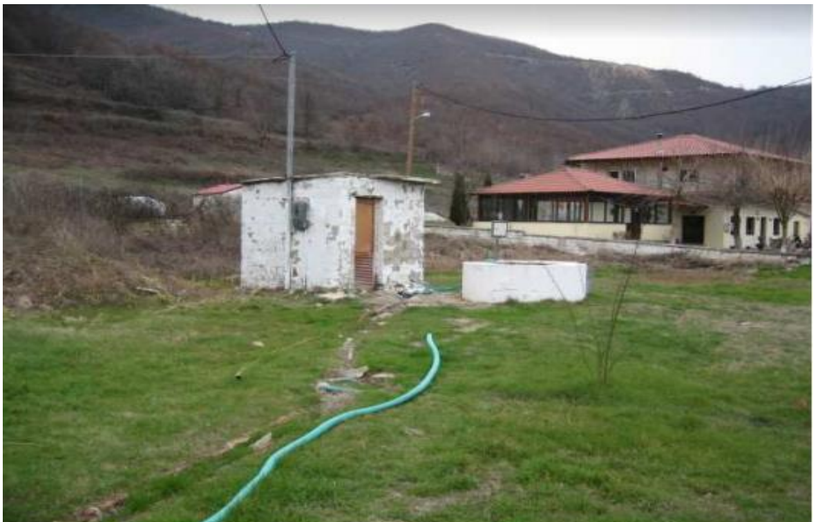
Εικόνα 4.7: Αντλιοστάσιο και πηγάδι άντλησης
