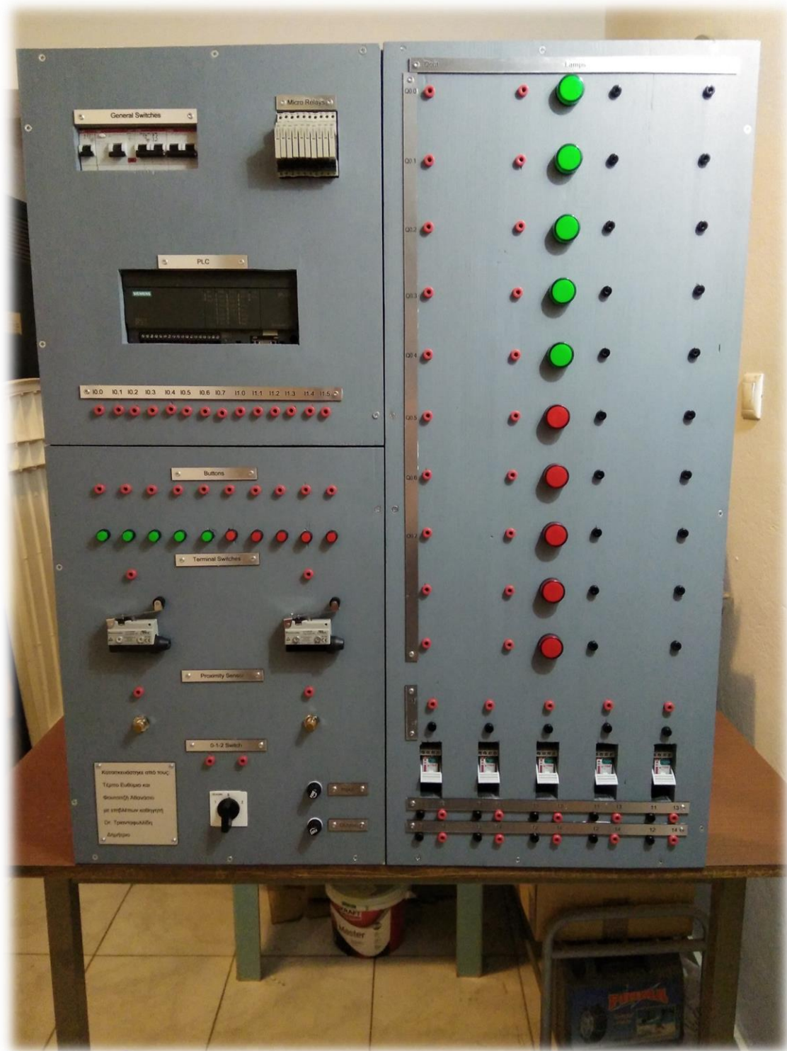
Εικόνα 90. Ολοκλήρωση της κατασκευής (Τελικό αποτέλεσμα εκπαιδευτικής μονάδας επίδειξης εγκατάστασης αυτοματισμού με βάση Προγραμματιζόμενο Λογικό ελεγκτή).
