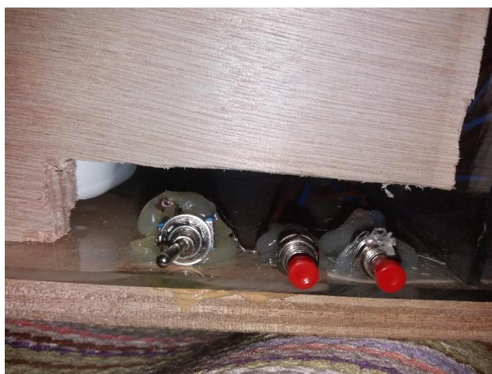
Εικόνα 34: Τοποθέτηση διακόπτη ON – OFF, μπουτόν παύσης λειτουργίας μάντα μεταφοράς λόγω βλάβης και μπουτόν βλάβης για έξοδο αυτοκινήτου με ασφάλεια
