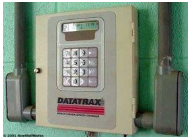
Εικόνα 4: Ψηφιακό Σύστημα Ελέγχου (DCS) [18]
