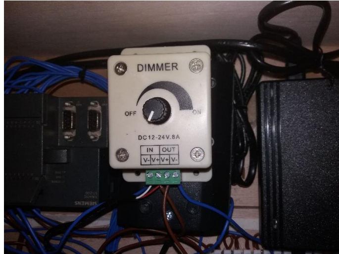
Εικόνα 37: Τοποθέτηση Dimmer μείωσης στροφών κινητήρα μάντα μεταφοράς
