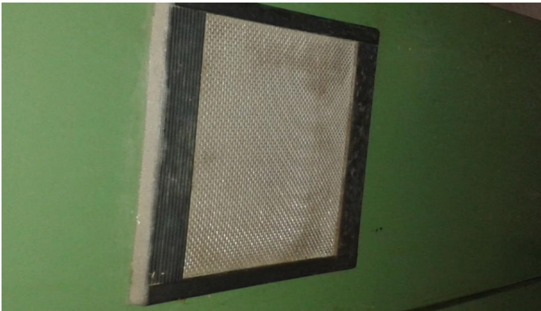
Εικόνα 4.2.7: Είσοδος παροχής αέρα για την ψύξη των ηλεκτρικών εγκαταστάσεων
