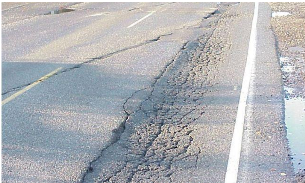
Εικόνα 1.12 Ρωγμές στην τροχιά των τροχών ( www.roadscience.net )
