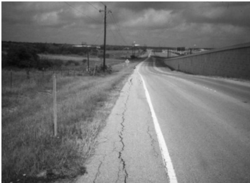
Εικόνα 1.4 Ρωγμές στα άκρα του οδοστρώματος ( www.asphaltinstitute.org )
