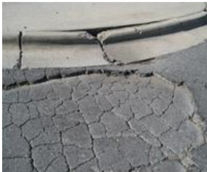
Εικόνα 1.20 Αποφλοιώση οδοστρώματος ( www.mrpothole.com )
