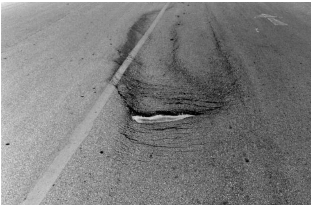
Εικόνα 1.8 Ρωγμές από ολίσθηση ταπήτων ( www.asphaltinstitute.org )
