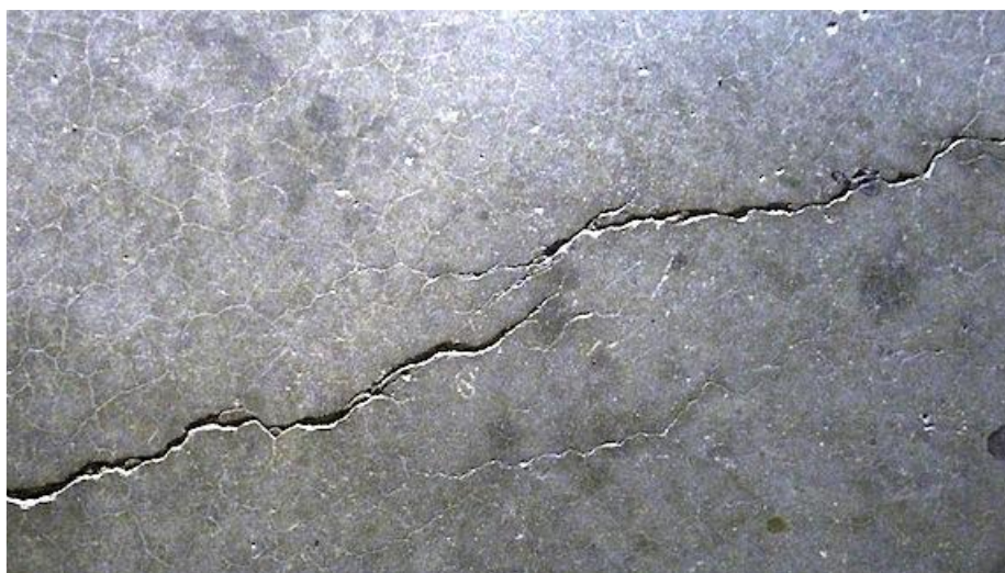
Εικόνα 1.10 Ρωγμές συρρίκνωσης ( www.nachi.org )
