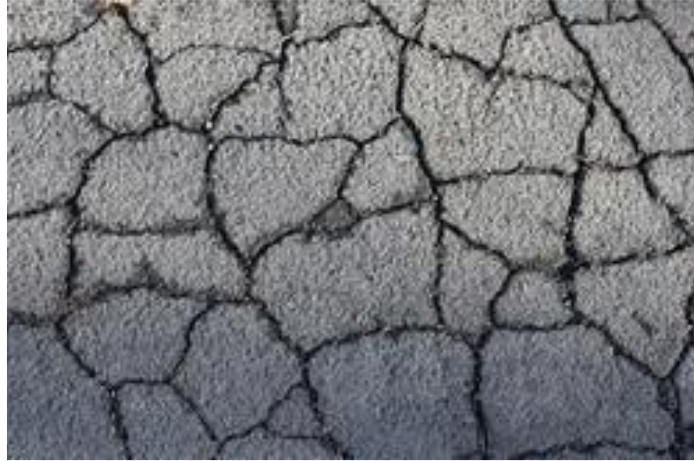
Εικόνα 1.2 Ρωγμές τύπου αλιγάτορα ( www.prestige-sealcoating.com )
