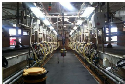
Εικόνα 2. Δίκτυο σωληνώσεων στην αίθουσα άμελης.
