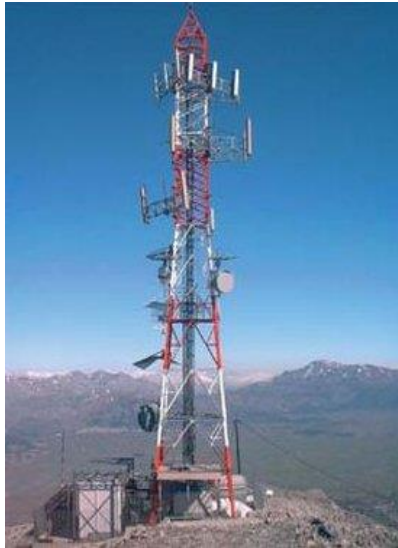
Εικόνα 3.2 Σταθμός βάσης κινητής τηλεφωνίας
