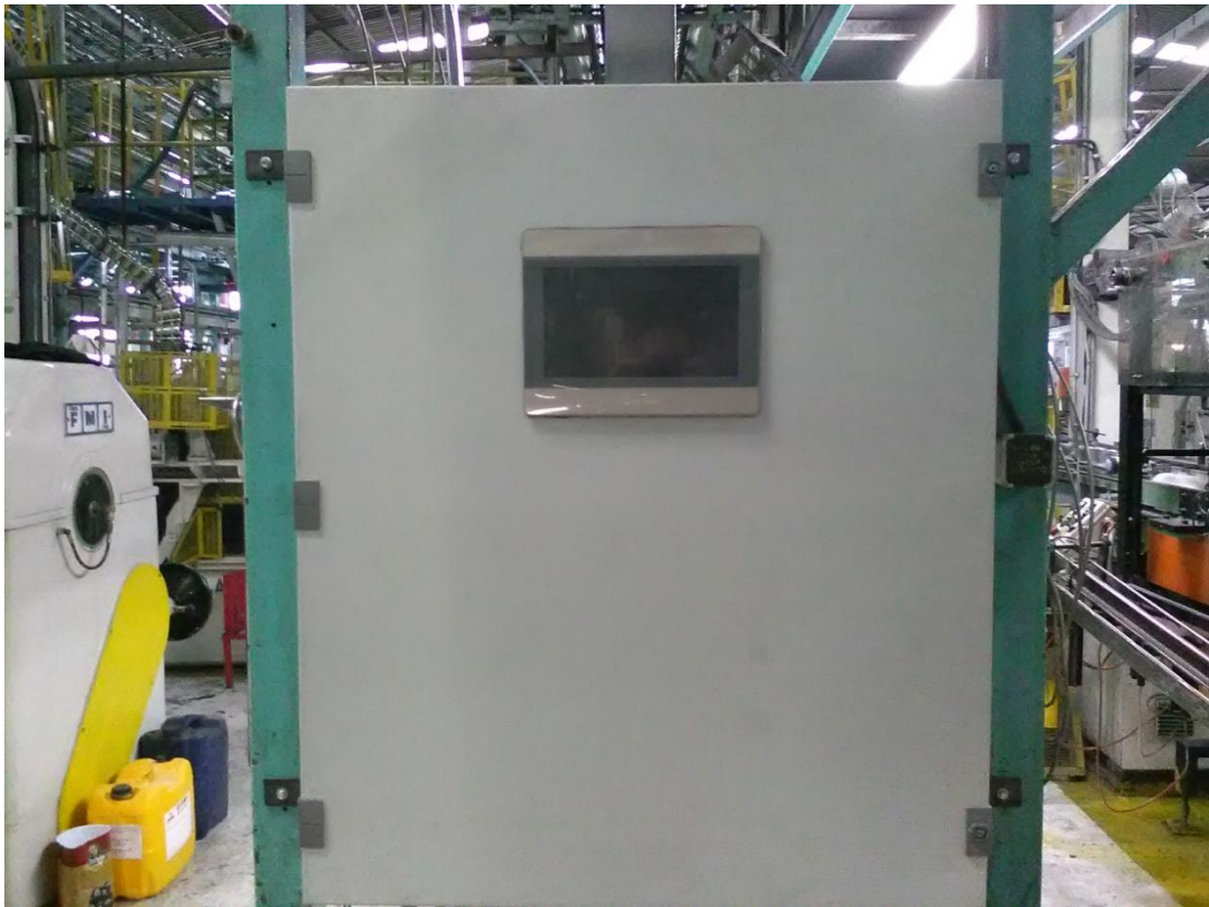
Σχήμα 13: Πρόσοψη ηλεκτρολογικού πίνακα
