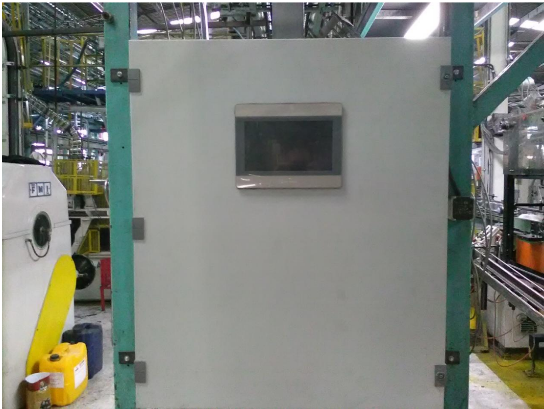
Σχήμα 26: Φωτογραφία πρόσοψης ηλεκτρολογικού πίνακα όπου φαίνεται η οθόνη HMI
