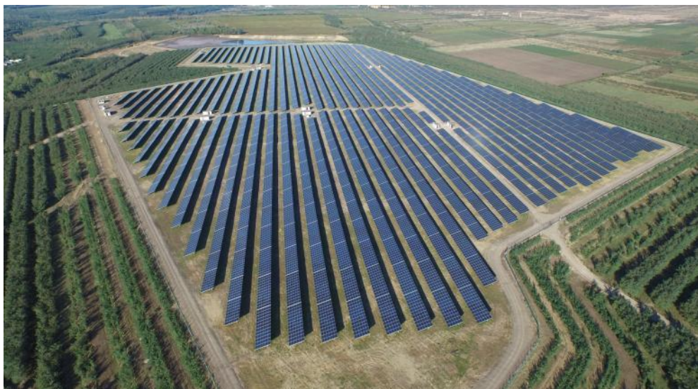
Εικόνα 13. Φωτοβολταϊκό Πάρκο στην Περιοχή της Λάρισας
