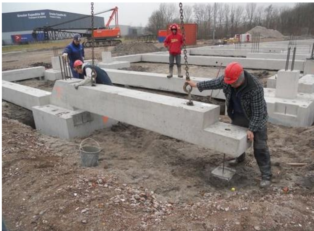
Σχήμα 1.7 Οπτικό υλικό από πραγματικές συνθήκες εγκατάστασης θεμελιώσεων πριν από την τοποθέτηση των προκατασκευασμένων κτιρίων.
