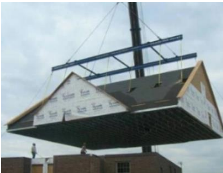
Σχήμα 2.2 Αναπαράσταση διαδικασίας ανύψωσης και τοποθέτησης τρισδιάστατου δομικού μπλοκ σκεπής με χρήση γερανού.
