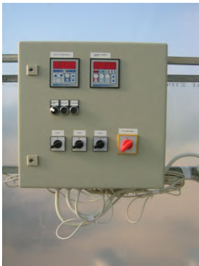
Εικόνα 11. Ηλεκτρολογικός πίνακας αυτοματισμού
