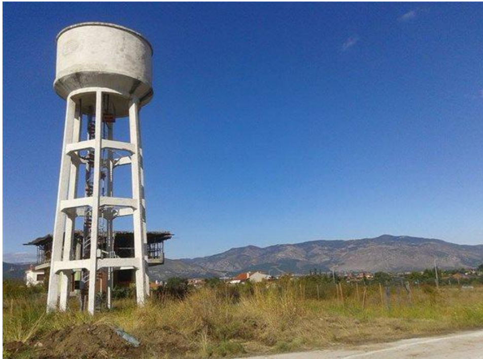
Εικόνα 1: Υδατόπυργος προς κατεδάφιση στην Τ.Κ Καλυβίων
