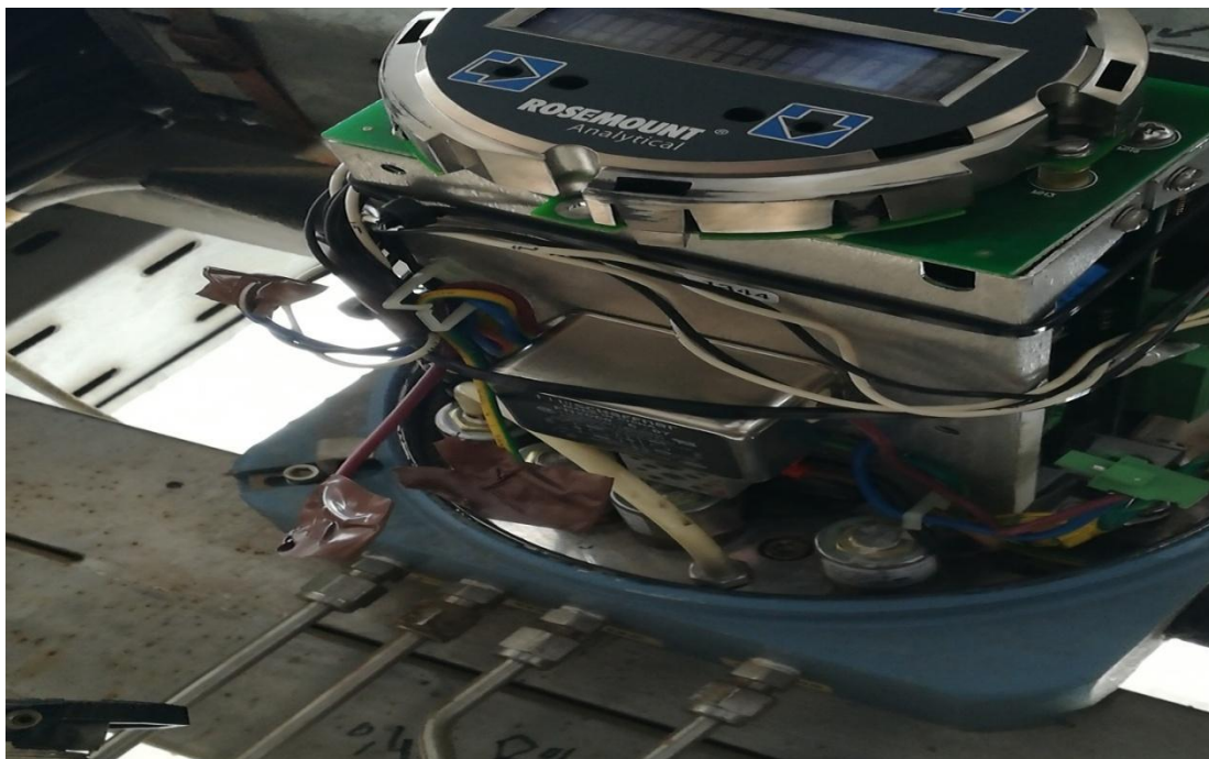
Εικόνα 1.3.7 Στο σημείο όπου έχει τοποθετηθεί μονωτική ταινία είναι τα καλώδια που συνδέονταν πάνω στο καμένο τροφοδοτικό και για ασφάλεια τοποθετήθηκε μονωτική.
