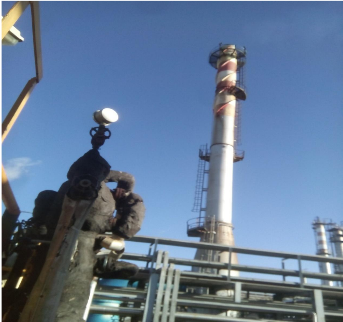
Εικόνα 2.4.3 Απεικονίζει το φουγάρο που έχει τοποθετηθεί ο αναλυτής υδρόθειου. Όταν παρατηρούμε νέφη να βγαίνουν από αυτό το φουγάρο τόσο μεγαλύτερη είναι η μόλυνση στο περιβάλλον, αλλά και για τους τεχνίτες σημαίνει ότι ο αναλυτής δε δουλεύει σωστά.
