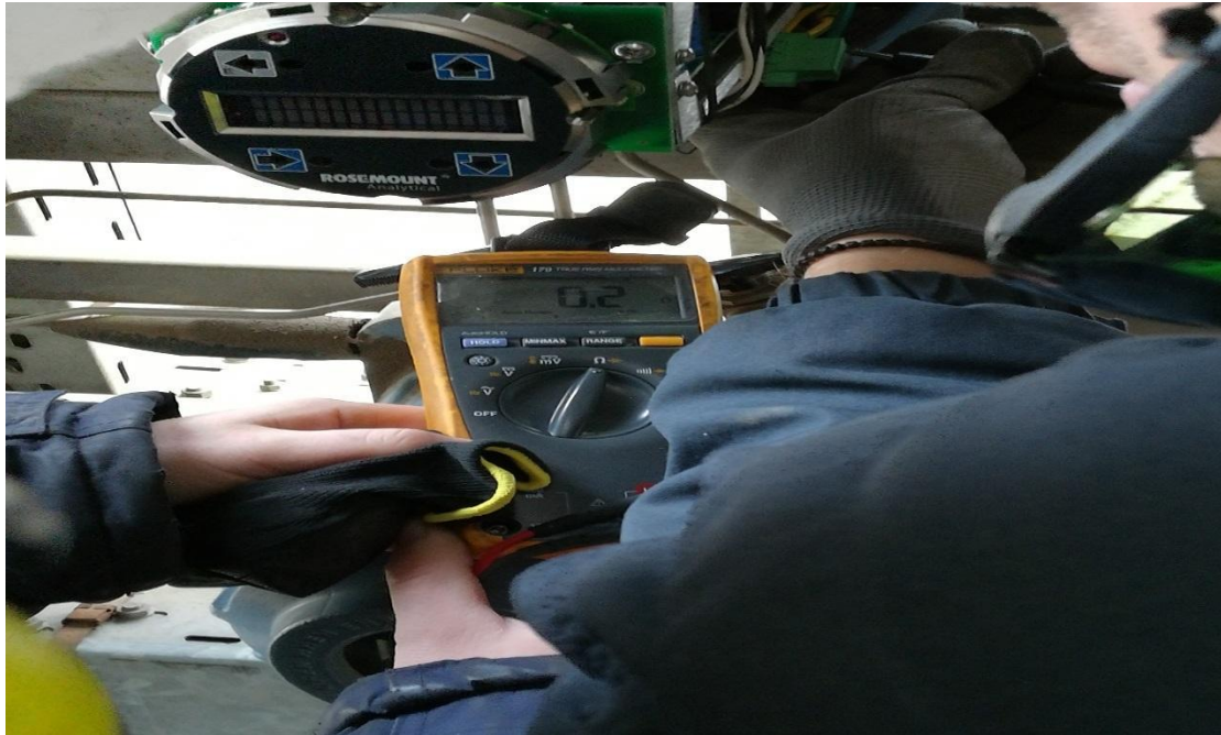
Εικόνα 1.3.6. Μέτρηση με αμπερόμετρο στις καλωδιώσεις του ενδείκτη
