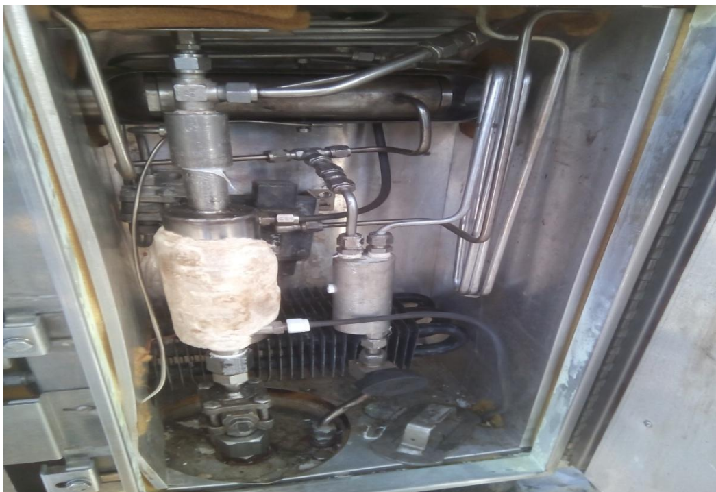
Εικόνα 2.3.2 Εσωτερικό Αναλυτή Υδρόθειου και Διοξείδιο του άνθρακα σε διυλιστήριο.
