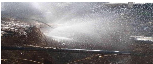
Εικόνα 6. σπάσιμο αγωγού ύδρευσης
