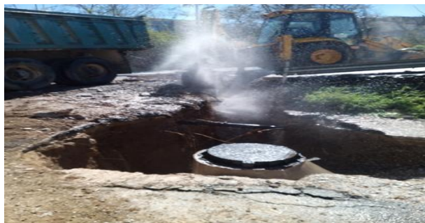
Εικόνα 21. Βλάβη στον αγωγό ύδρευσης
