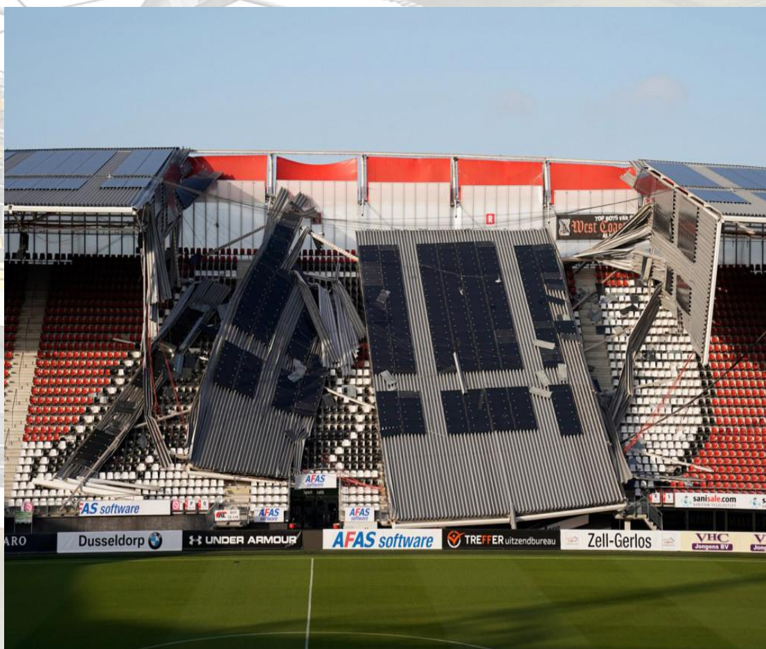
Εικόνα 31 Κατάρρευση τμήματος στεγάστρου λόγω θυελλωδών ανέμων, Ολλανδία- Γήπεδο Alkmaar F.C. Πηγή: E- NEWS.US
