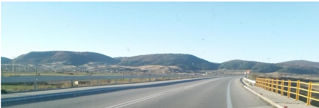
Εικόνα 87: Απεικόνιση της επιφάνειας κύλισης του οδοστρώματος και των κιγκλιδωμάτων της κάτω διάβασης ΚΔ.04.Ε.Ο.3.
