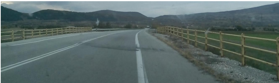
Εικόνα 70: Μπαλώματα στην επιφάνεια κύλισης του οδοστρώματος και επιφανειακή οξείδωση των κιγκλιδωμάτων της κάτω διάβασης ΚΔ.02.Ε.Ο.3.
