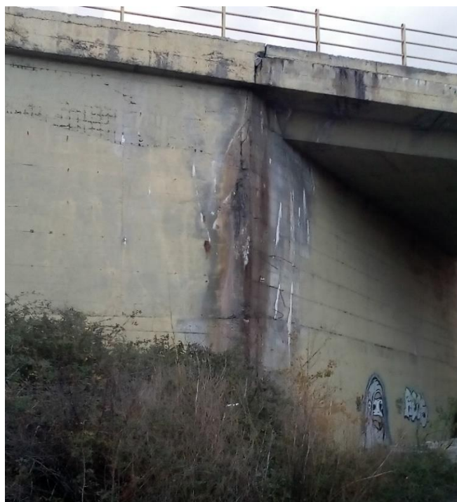
Εικόνα 36: Απεικόνιση των φθορών του βορειοδυτικού ακροβάθρου της γέφυρας ΓΕ.02.Ε.Ο.3.
