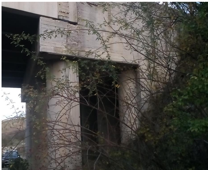
Εικόνα 62: Απεικόνιση της διαβροχής του σκυροδέματος στον πτερυγότοιχο της κάτω διάβασης ΚΔ.01.Ε.Ο.3.
