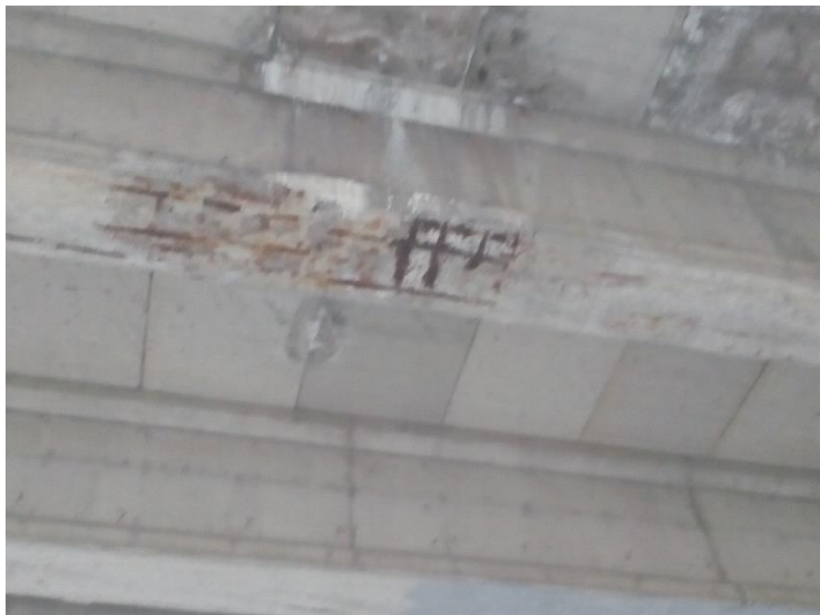
Εικόνα 51: Έκθεση και οξείδωση σπλισμού στις δοκούς της κάτω παρειάς της πλάκας της γέφυρας ΓΕ.03.Ε.Ο.3.
