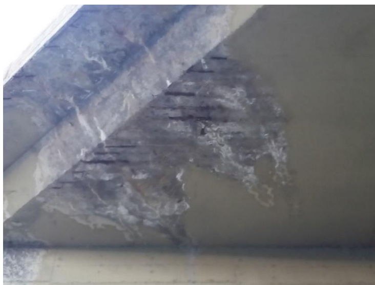
Εικόνα 68: Απεικόνιση των φθορών της πλαϊνής πλευράς και της κάτω παρειάς της πλάκας της κάτω διάβασης ΚΔ.02.Ε.Ο.3.
