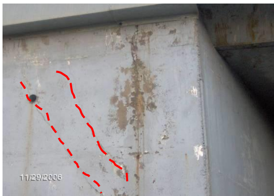
Εικόνα 24: Ρηγματώσεις του ακροβάθρου κάτω διάβασης της Εγνατίας Οδού, (ΕΓΝΑΤΙΑ ΟΔΟΣ Α.Ε.)
