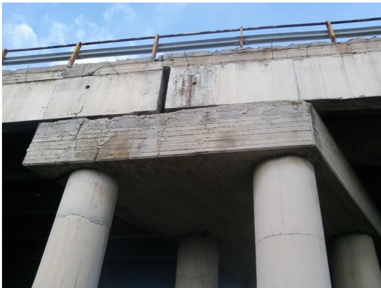
Εικόνα 31: Έκθεση και οξείδωση σπλισμού των δοκών της πλαϊνής πλευράς της κάτω παρειάς της πλάκας της γέφυρας ΓΕ.01.Ε.Ο.3.
