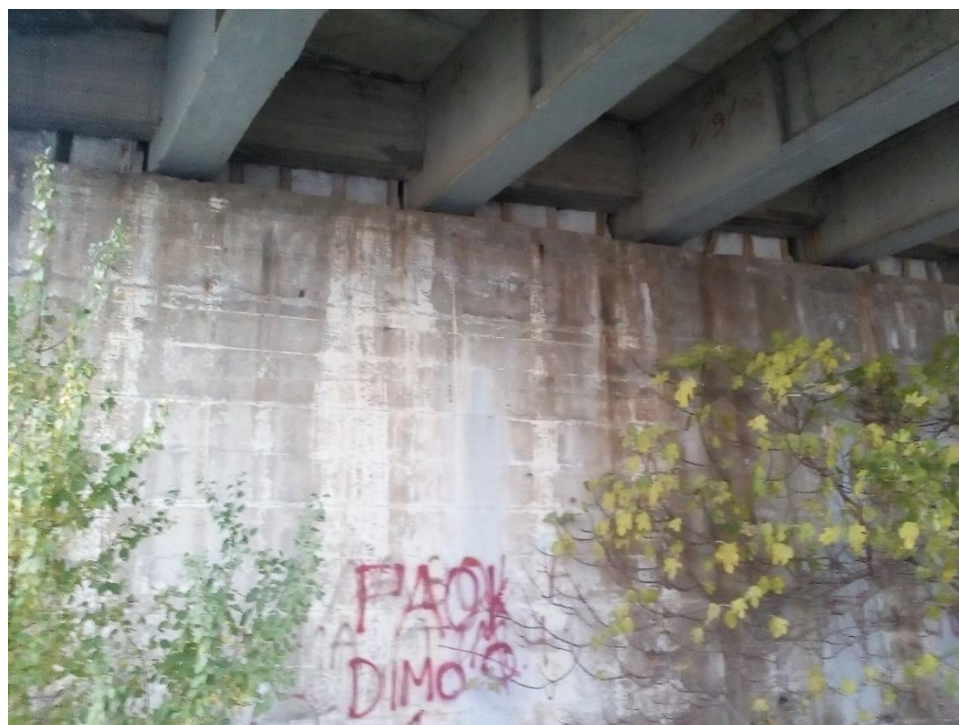
Εικόνα 48: Απεικόνιση των φθορών του νότιου ακροβάθρου της γέφυρας ΓΕ.03.Ε.Ο.3.
