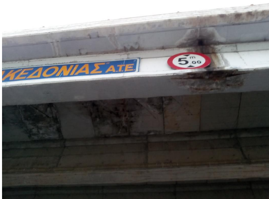
Εικόνα 50: Απεικόνιση των φθορών της πλαϊνής πλευράς και της κάτω παρειάς της πλάκας της γέφυρας ΓΕ.03.Ε.Ο.3.
