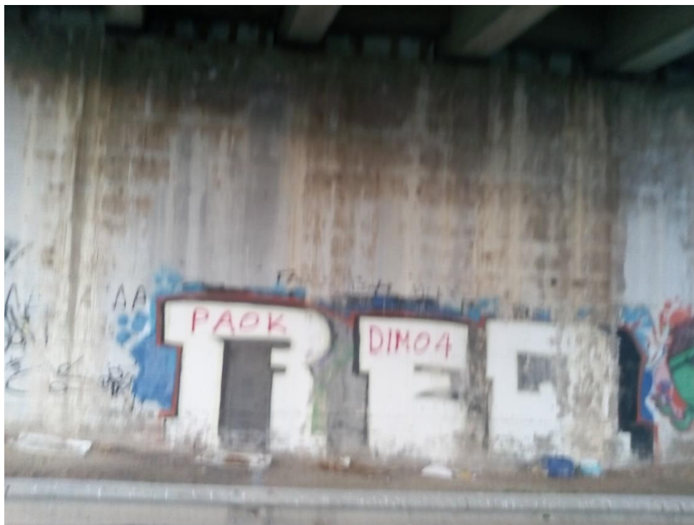
Εικόνα 47: Απεικόνιση των φθορών του βόρειου ακροβάθρου της γέφυρας ΓΕ.03.Ε.Ο.3.
