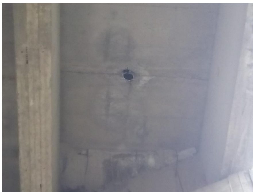
Εικόνα 58: Τοπική εξάνθηση στην κάτω παρειά της πλάκας του καταστρώματος της κάτω διάβασης ΚΔ.01.Ε.Ο.3.
