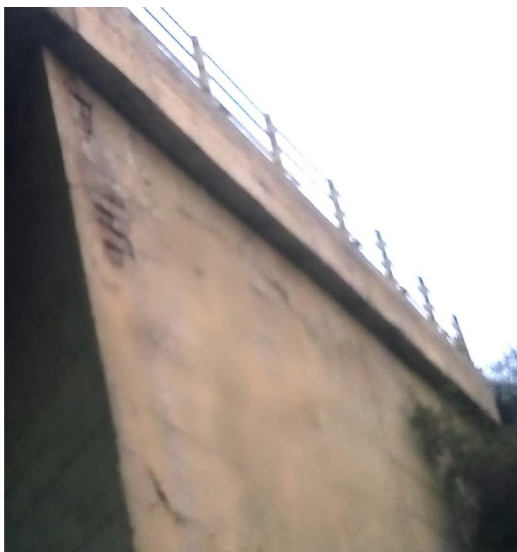
Εικόνα 44: Απεικόνιση των φθορών του βορειοδυτικού περυγότοιχου της γέφυρας ΓΕ.02.Ε.Ο.3.
