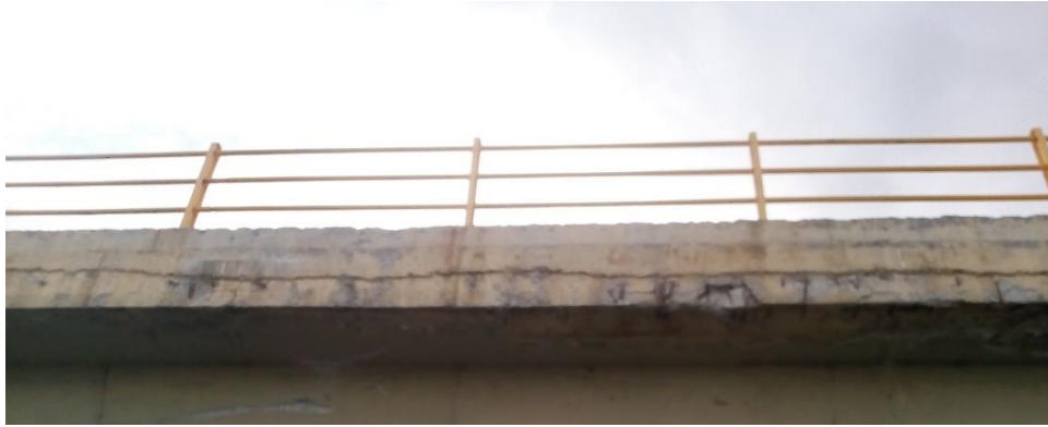
Εικόνα 85: Απεικόνιση των φθορών της πλαϊνής πλευράς της κάτω παρειάς της πλάκας της κάτω διάβασης ΚΔ.04.Ε.Ο.3.
