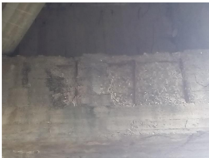
Εικόνα 30: Έκθεση και οξείδωση του οπλισμού των δοκών της κάτω παρειάς της πλάκας της γέφυρας ΓΕ.01.Ε.Ο.3.
