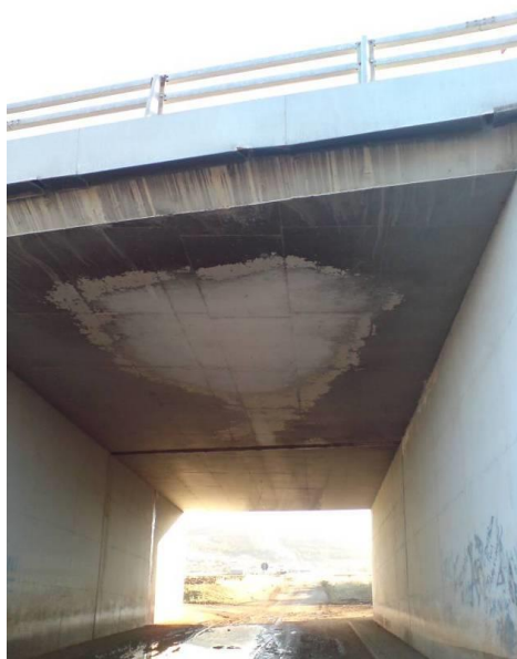
Εικόνα 22: Εξάνθηση του σκυροδέματος της κάτω παρειάς της πλάκας κάτω διάβασης της Εγνατίας Οδού, (ΕΓΝΑΤΙΑ ΟΔΟΣ Α.Ε.)
