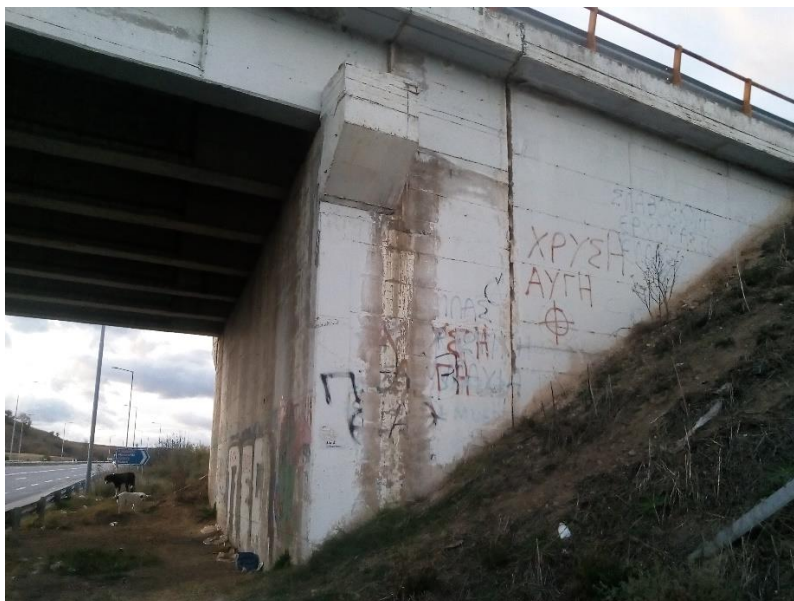
Εικόνα 53: Απεικόνιση των φθορών στον δυτικό περυγότοιχο της γέφυρας ΓΕ.03.Ε.Ο.3.
