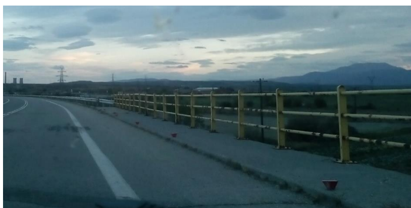
Εικόνα 42: Επιφανειακή οξείδωση των κιγκλιδωμάτων της γέφυρας ΓΕ.02.Ε.Ο.3.
