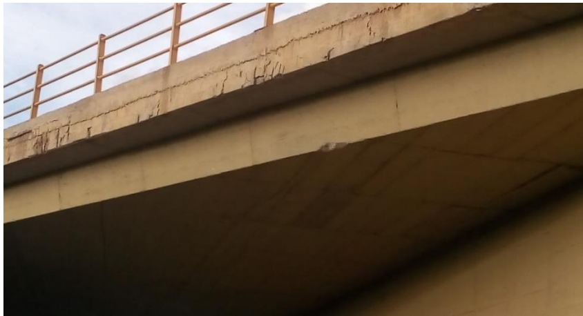
Εικόνα 86: Προσκρούσεις στην πλαϊνή πλευρά της κάτω παρειάς της πλάκας της κάτω διάβασης ΚΔ.04.Ε.Ο.3.
