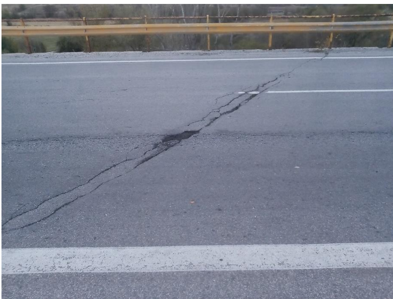
Εικόνα 32: Ρηγματώσεις και βυθίσεις στην περιοχή των αρμών στην επιφάνεια κύλισης της γέφυρας ΓΕ.01.Ε.Ο.3.
