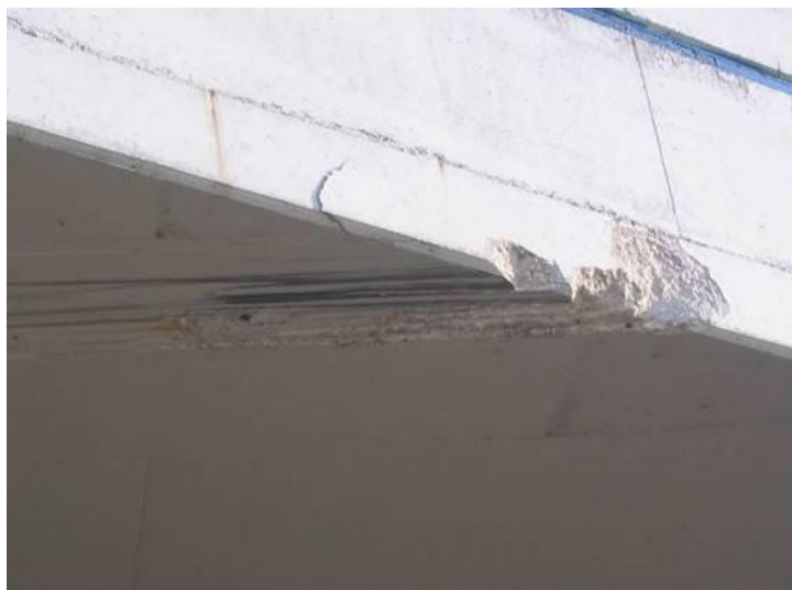
Εικόνα 26: Προσκρούσεις στην πλαϊνή και κάτω παρειά της πλάκας κάτω διάβασης της Εγνατίας Οδού, (ΕΓΝΑΤΙΑ ΟΔΟΣ Α.Ε.)
