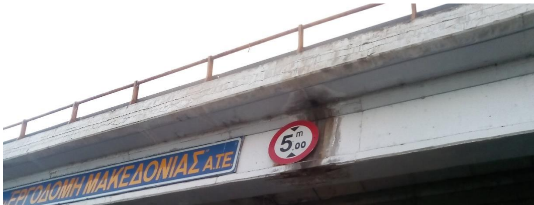
Εικόνα 49: Απεικόνιση των φθορών της πλαϊνής πλευράς της κάτω παρειάς της πλάκας της γέφυρας ΓΕ.03.Ε.Ο.3.
