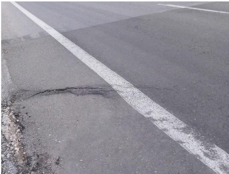
Εικόνα 33: Ρηγματώσεις στην επιφάνεια κύλισης της γέφυρας ΓΕ.01.Ε.Ο.3.
