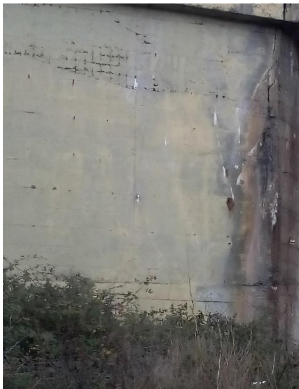
Εικόνα 43: Απεικόνιση των φθορών του ανατολικού περυγότοιχου της γέφυρας ΓΕ.02.Ε.Ο.3.
