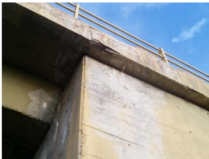
Εικόνα 77: Απεικόνιση των φθορών της πλαϊνής πλευράς της κάτω παρειάς της πλάκας της κάτω διάβασης ΚΔ.03.Ε.Ο.3.
