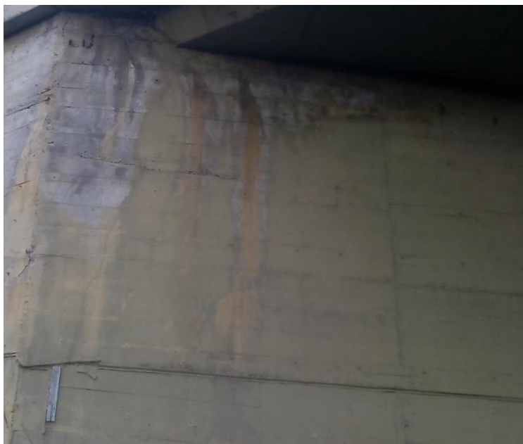
Εικόνα 37: Απεικόνιση των φθορών του ανατολικού ακροβάθρου της γέφυρας ΓΕ.02.Ε.Ο.3.
