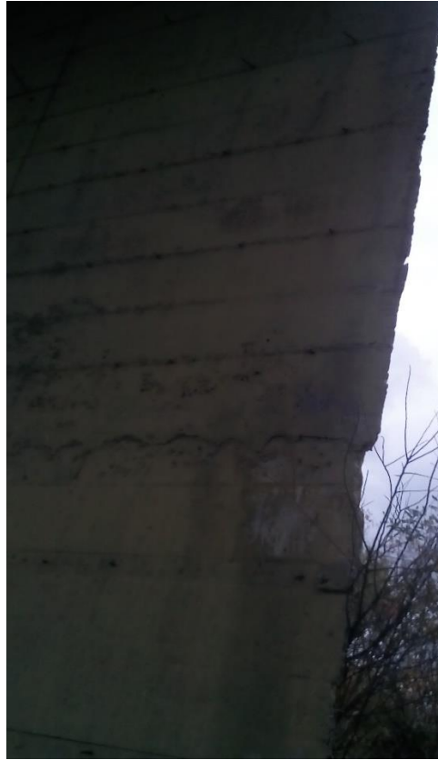
Εικόνα 38: Πλευρικές προσκρούσεις, χωρίς έκθεση οπλισμού, στο ανατολικό ακρόβαθρο της γέφυρας ΓΕ.02.Ε.Ο.3.
