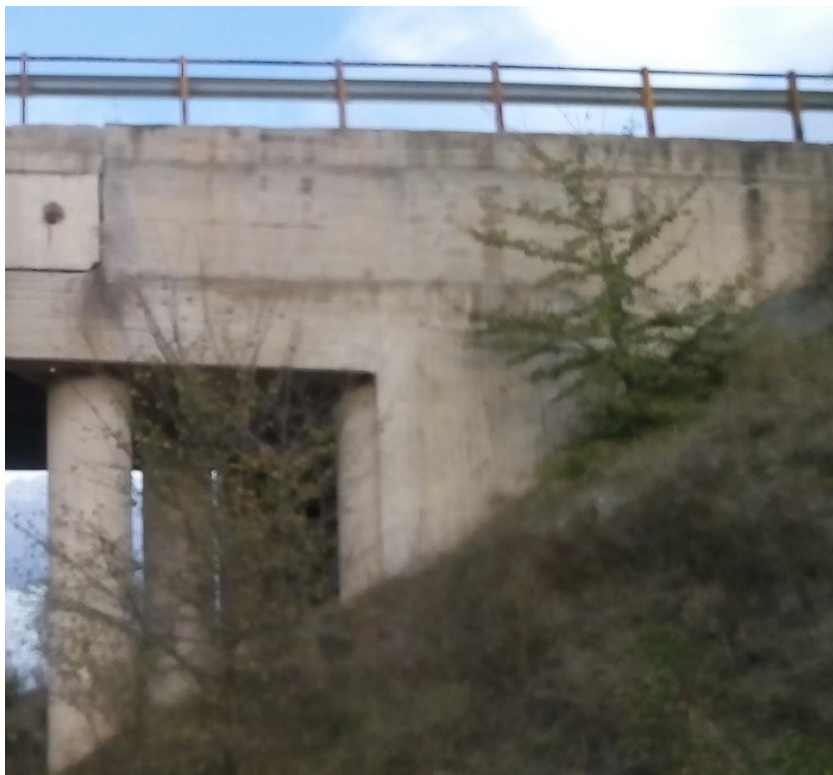
Εικόνα 34: Απεικόνιση των φθορών στον πτερυγότοιχο της γέφυρας ΓΕ.01.Ε.Ο.3.
