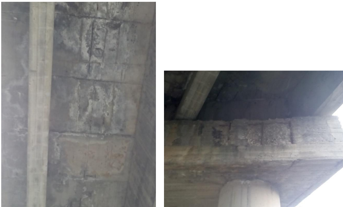
Εικόνα 59: Διαβροχή, εξάνθηση, έκθεση και οξείδωση οπλισμού στην κάτω παρειά της πλάκας της κάτω διάβασης
