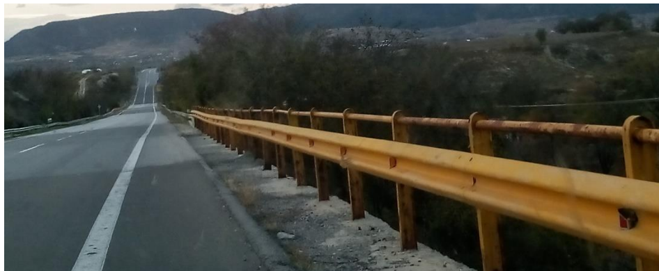
Εικόνα 61: Οξείδωση των κιγλιδωμάτων της κάτω διάβασης ΚΔ.01.Ε.Ο.3.
