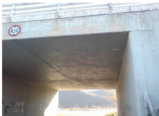
Εικόνα 21: Αποφλοίωση του σκυροδέματος της πλαϊνής πλευράς της κάτω παρειάς της πλάκας κάτω διάβασης της Εγνατίας Οδού, (ΕΓΝΑΤΙΑ ΟΔΟΣ Α.Ε.)
