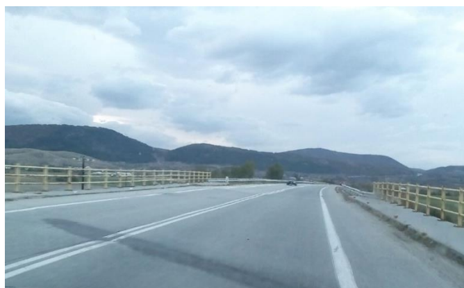
Εικόνα 41: Μπαλώματα στην επιφάνεια κύλισης του οδοστρώματος της γέφυρας ΓΕ.02.Ε.Ο.3.
