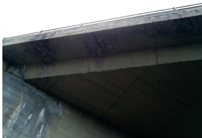
Εικόνα 39: Απεικόνιση των φθορών της πλαϊνής πλευράς της κάτω παρειάς της πλάκας της γέφυρας ΓΕ.02.Ε.Ο.3.
