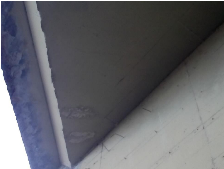
Εικόνα 69: Απεικόνιση των φθορών της πλαϊνής πλευράς και της κάτω παρειάς της πλάκας της κάτω διάβασης ΚΔ.02.Ε.Ο.3.
