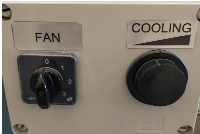
Σχήμα 3.34. Μονάδα ελέγχου επεξεργασίας αέρα
