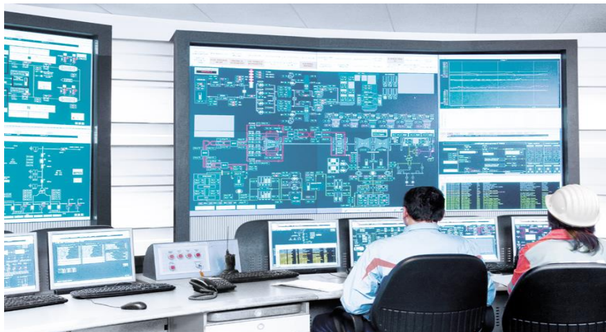
Εικόνα 1.1: Αίθουσα χειρισμού σταθμών SCADA σε βιομηχανία
