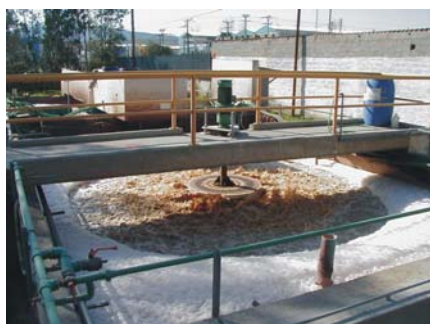
Φωτογραφία 13: Μονάδα επεξεργασίας λυμάτων
