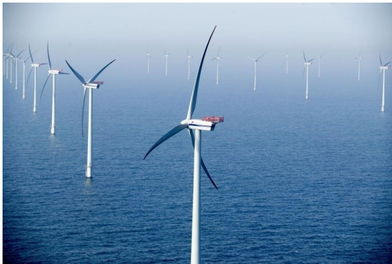
Εικόνα 5. Αιολικό πάρκο Offshore. Πηγή: The Roosevelt Institution
