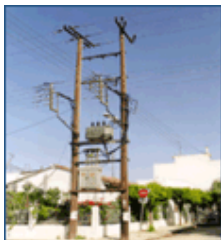
Δίκτυο με γυμνούς αγωγούς
