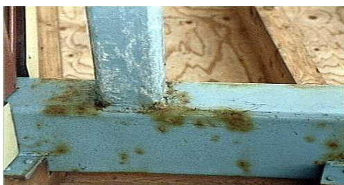
Φωτ. 1.2 Τοπική διάβρωση χάλυβα
