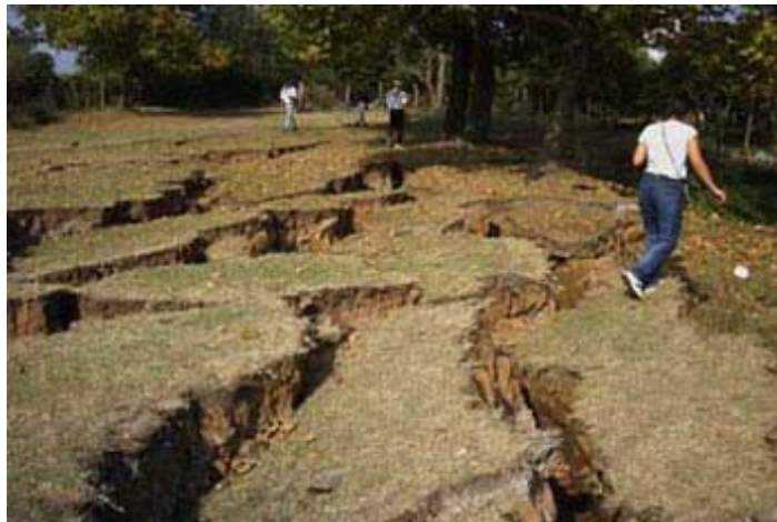
Εδαφικές ρωγμές που παρατηρήθηκαν αμέσως μετά το σεισμό της 17 ης Αυγούστου 1999 ( M=7,5 ) στην περιοχή της Νικομήδειας (Izmit) της Τουρκίας.
