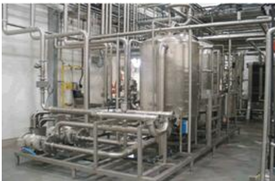
Εικ.6 μονάδα υπερδιήθησης (τμήμα τροφοδοσίας και διήθησης)
