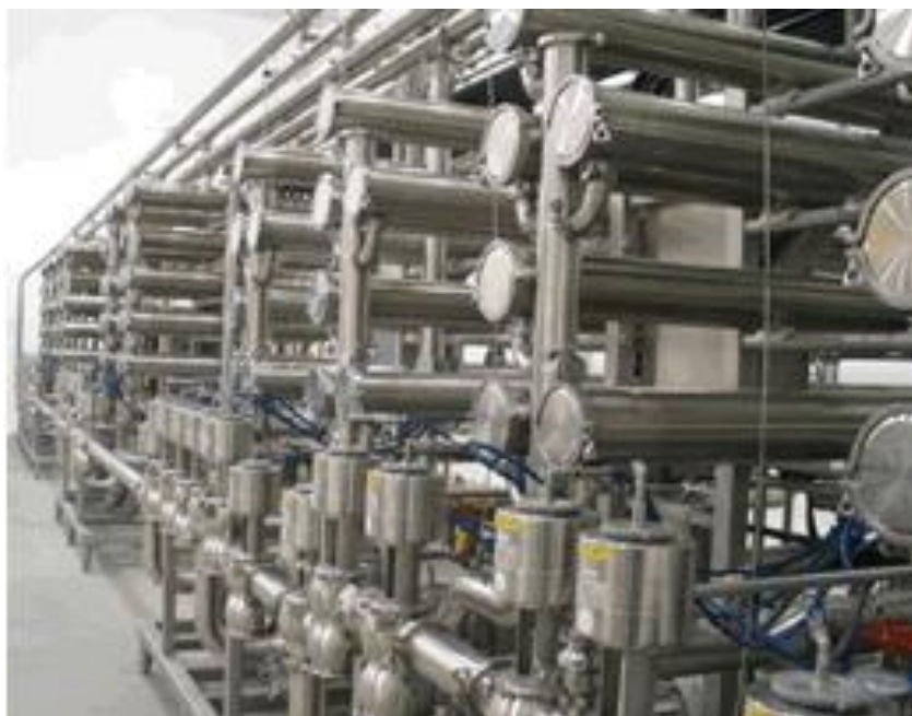
Εικ.5 εγκαταστάσεις υπερδιήθησης
