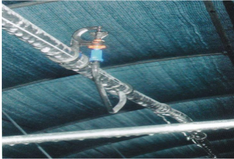
Εικόνα 24. Ψεκαστήρες (μπέκ υδρονέφωσης)
