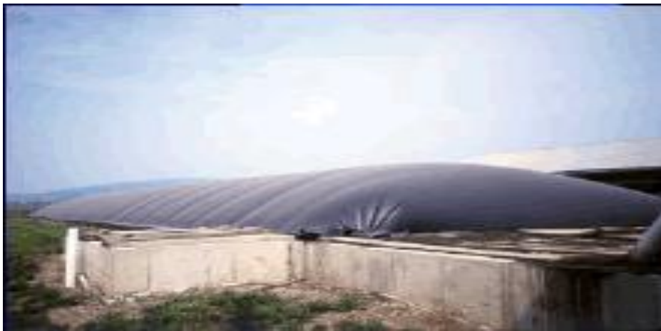
Εικόνα 5 Μονάδα παραγωγής βιοαερίου
