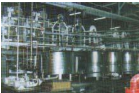
Εικ.13.14 Διηθητικό συγκρότημα χυμού και δεξαμενές υποδοχής.
