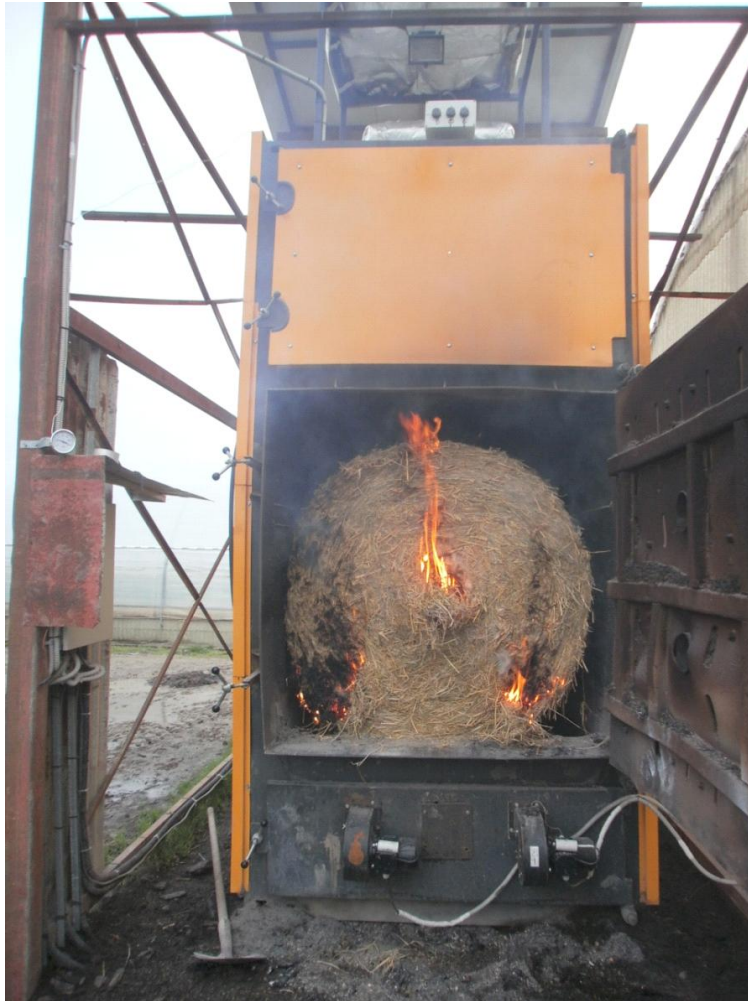
Εικόνα 34 Λέβητας καύσης φυτικών υπολειμμάτων ρυζιού
